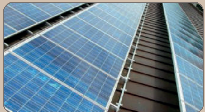
Abb. 108: Photovoltaikanlagen (SWM - Stadtwerke München, o.J.)
