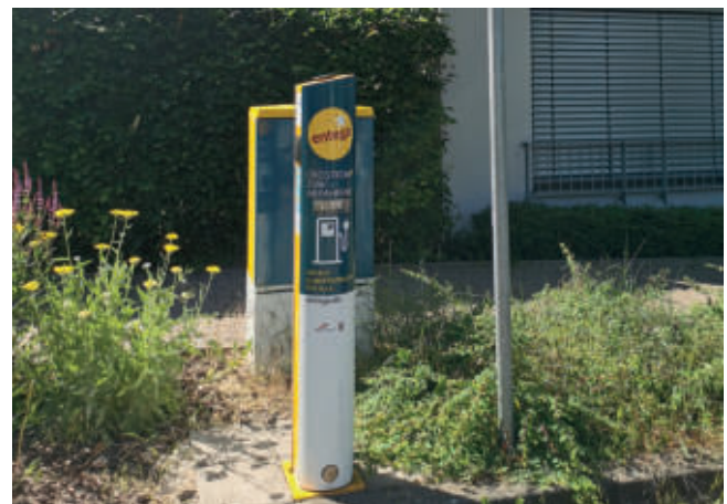
Abb. 59: Elektro-Ladestation am Parkplatz Auf der Leer (Eigene Aufnahme, 2020)
